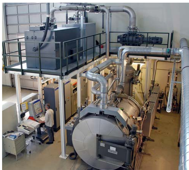
Fig. 1 VLPPS system at the Institute of Energy Research (IEF-1), Forschungszentrum Jülich GmbH
